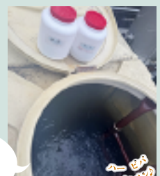
とある九州の掛け流し温泉施設の貯湯タンクの殺菌作業
